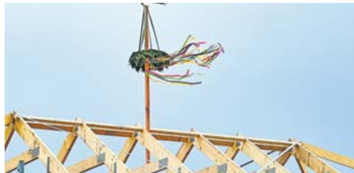
Die Dachkonstruktion steht, aber stimmt auch die Qualität? Während des Bauprozesses Teilabschnitte formell abzunehmen, kann für Bauherren nachteilig sein.
